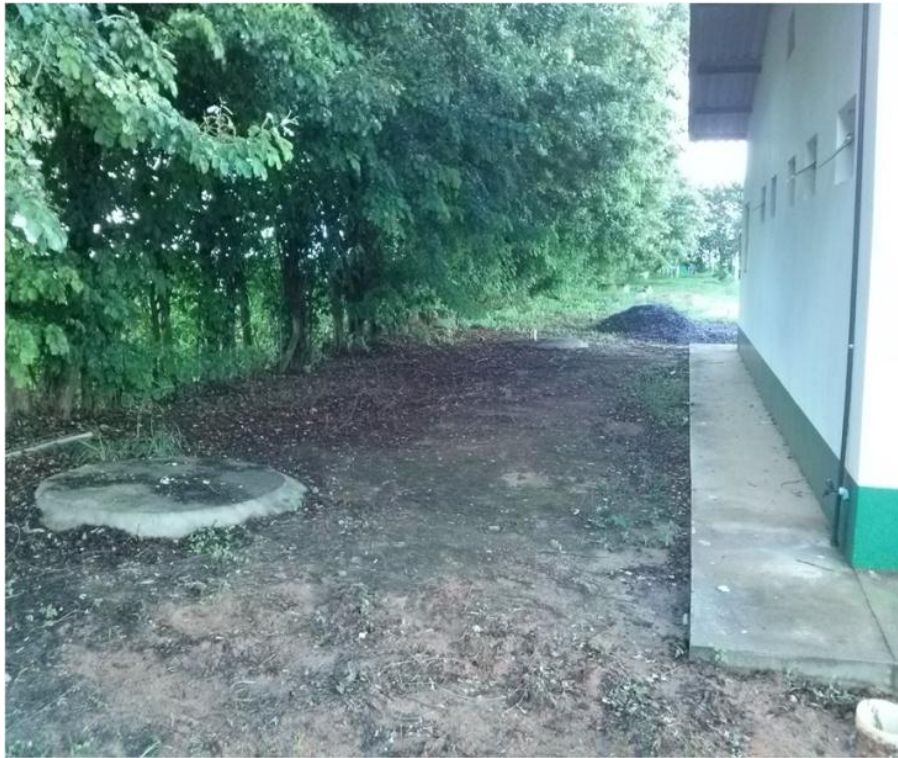
Figura 43: Fossa séptica para a água de lavagem de EPIs.
